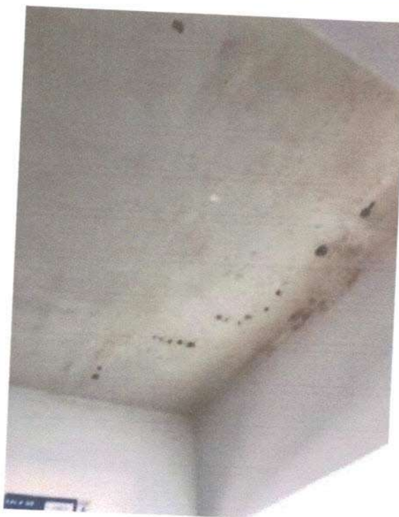
Ausência de Tela Milimétrica
